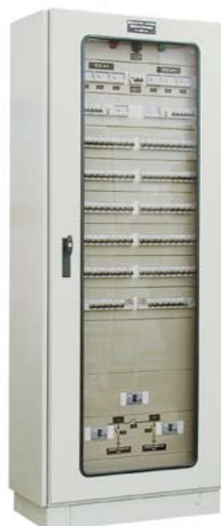
Rozdzielnica dwusekcyjna z aparaturą modułową
