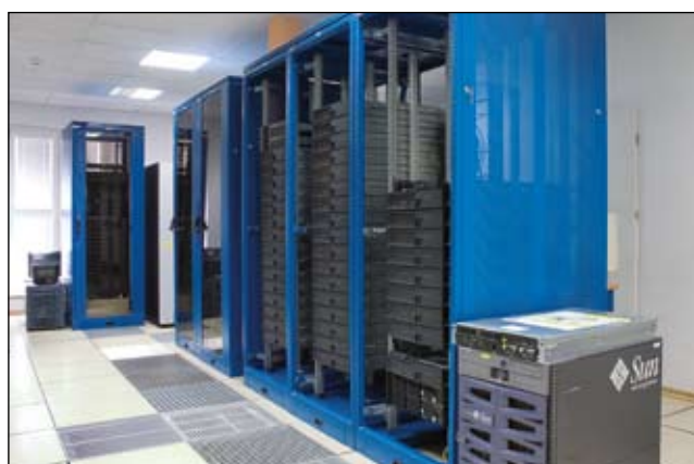
Szafy SZB SE w serwerowni Politechniki Wrocławskiej
